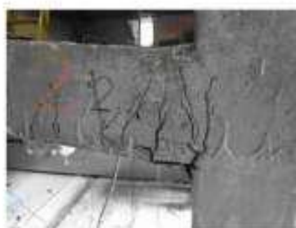
شکل ۴- خرابی تیر BS2 در اثر بارگذاری CFRP از روی تیر و بارگذاری FRP در پیچ
